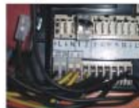
Zentraler Erdungspunkt zum Anschluss der Schutzleiter.
