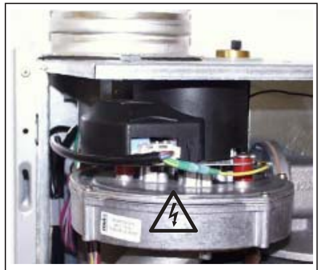
Gebläsestecker: Gefahr durch elektrische Spannung
